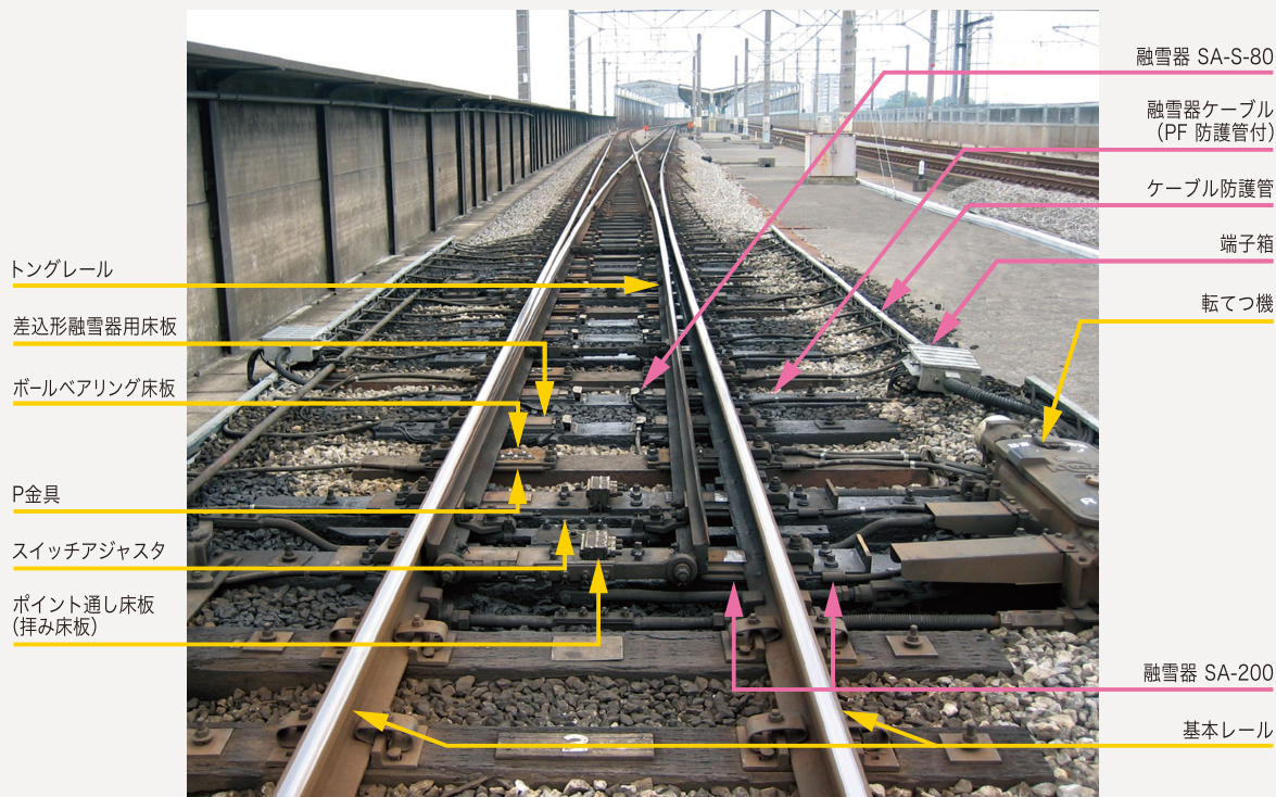
分岐器の構成と融雪器設備の配置状況
