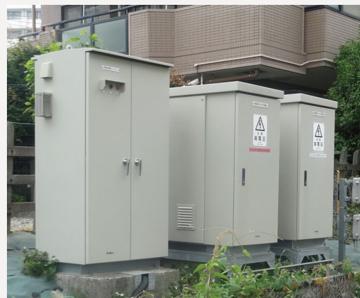
融雪器制御盤、コンパクト変圧器盤
